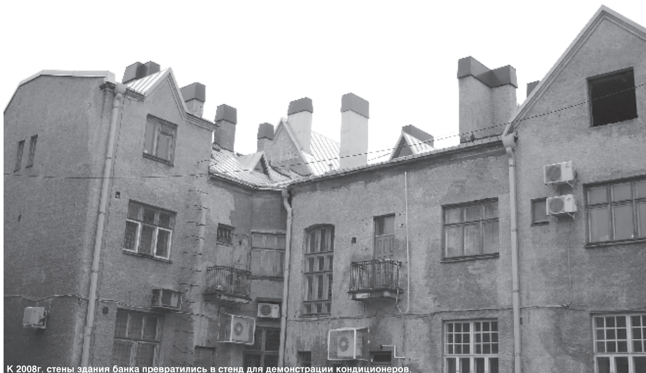
К 2008г. стены здания банка превратились в стенд для демонстрации кондиционеров.
